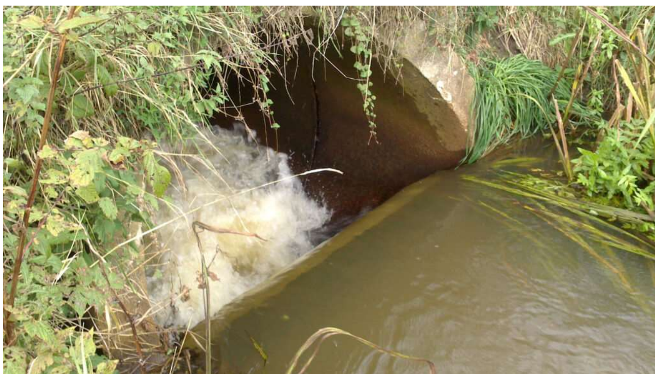
Foto 11. I mange tilløb til Gelså ses denne type overkørsler hvor det øverste betonrør har en indstøbt betonkant, som kan virke som spærring for både gydefisk og yngel.
